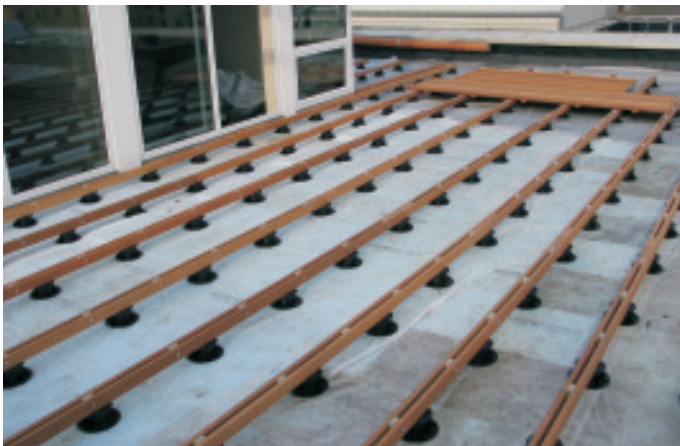
Holzunterbalken auf Diadem ® -Stelzlagern
